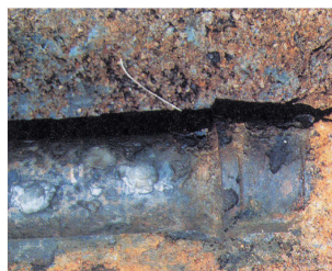
●経過年数：23年 ●管径65A ●腐食状況の所見：全体的に腐食による凹凸が発生している。
