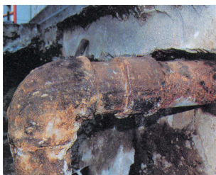
●経過年数：31年 ●管径：100A ●腐食状況の所見：管表面の亜鉛メッキがなく、腐食による凹凸が多少見受けられる。
